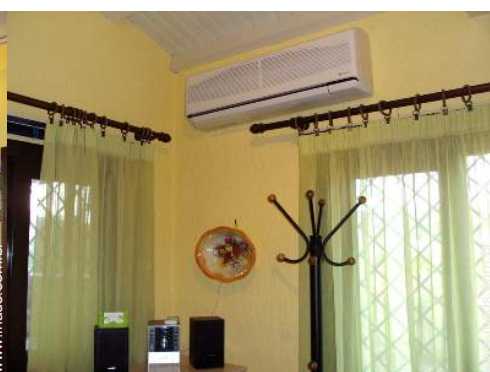
ar condicionado (totalmente)
